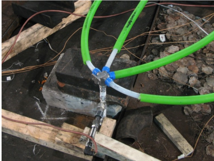
Kuva 19. Painemittarin kytkentä järjestelmien U1 ja U1_NAK tapauksissa.
