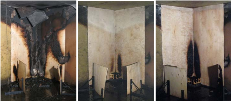
Kuva 21. Nurkkakokeen palokuormalle aiheutuneet tuhot vapaassa palossa (yllä) sekä kolmessa sammutuskokeessa (alla vasemmalta oikealle: U1, U1_NAK, U2). Keskimmäisessä kuvassa on selkeästi nähtävissä asuntosprinklerin kastelema osuus seinästä.
