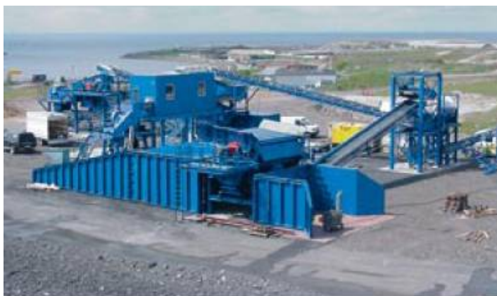
Kuva 2. SYSAV AB:n pohjakuonan käsittelylaitos.
