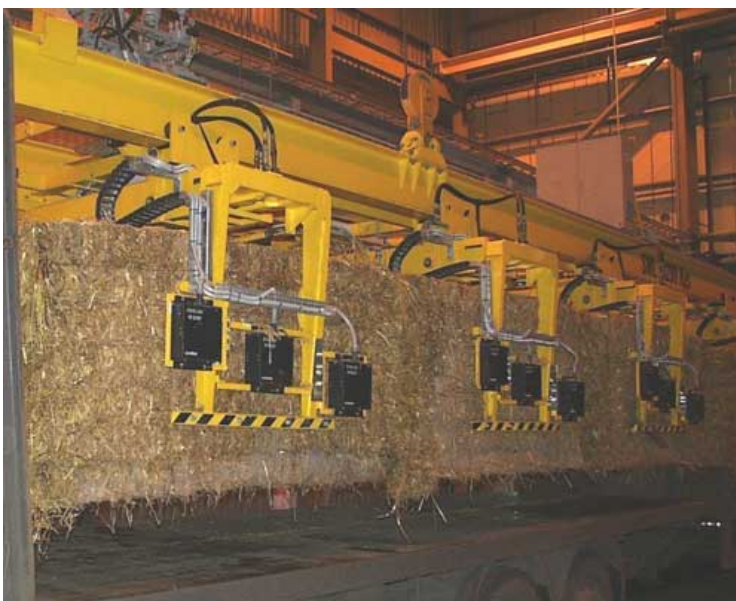
Kuva 57. DSE:n mikroaaltojen vaimenemiseen perustuva olkipaalimittaus tanskalaisella voimalaitoksella.
