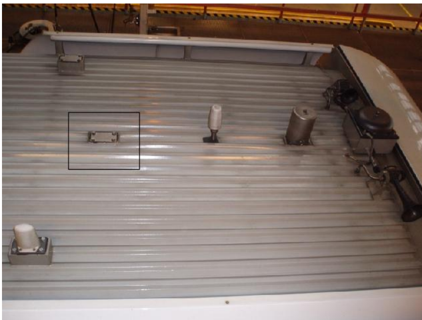
Kuva 18. Antenniläpivienti Dm12-kiskobussin katolla.
