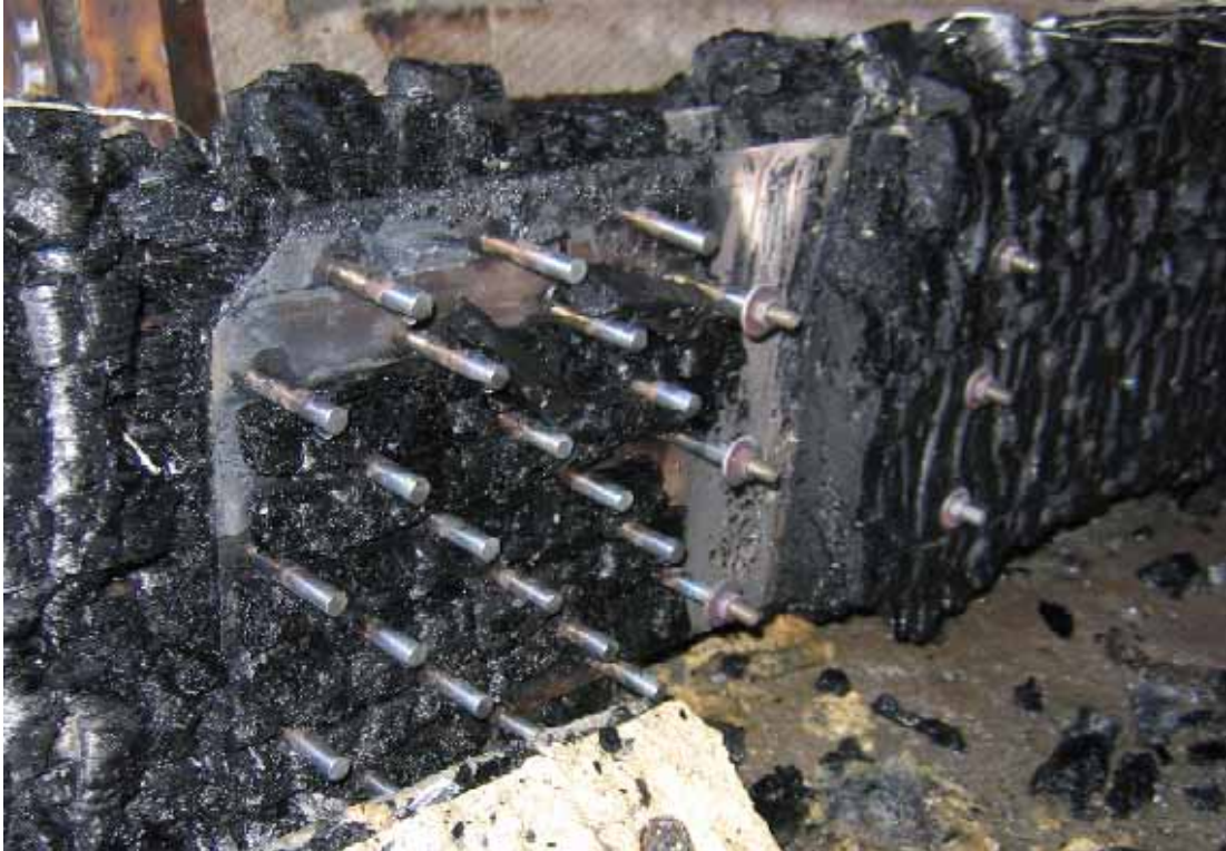
Kuva C.33. LP-liitos polttokokeen jälkeen.
