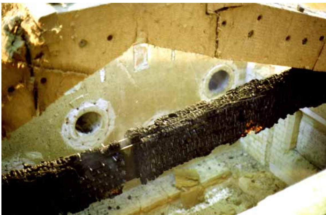
Kuva C.32. LP-liitos polttokokeen jälkeen.
