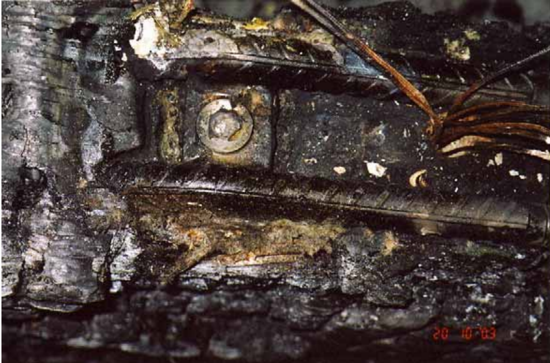
Kuva B.36. Toinen liitoksen ruuveista ehjä (kaksi lisähitsiä).
