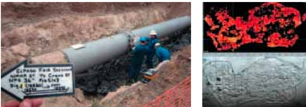
Kuvat 5 ja 6. Kuvassa 5 vasemmalla on meneillään oleva tarkastus. Oikealla kuvassa 6 on syöpyneen putken pinta ja tietokonekuva korroosiosta. [9]
