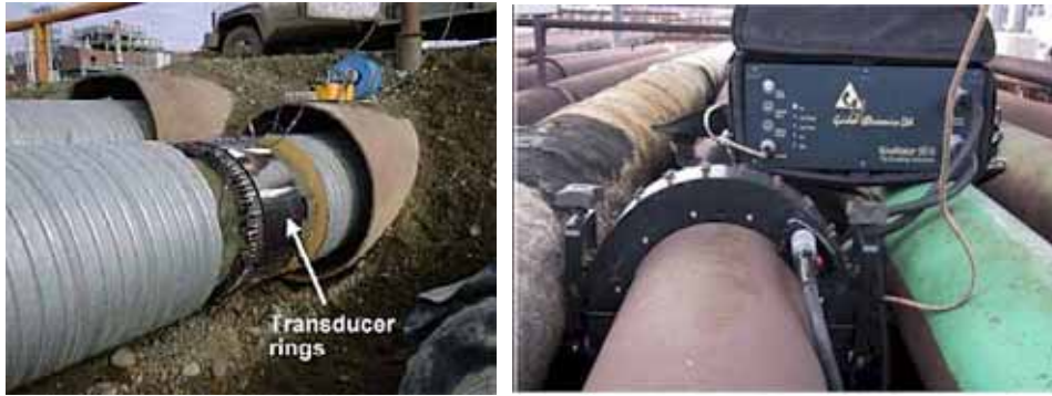
Kuvat 1 ja 2. Kuvissa on luotainpanta kiinnitettyinä mitattavaan putkeen. [13]
